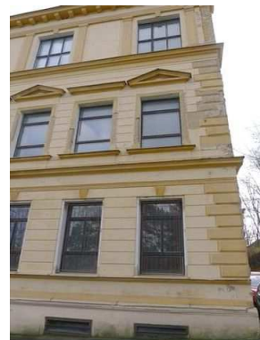
lokál. poškození fasády
