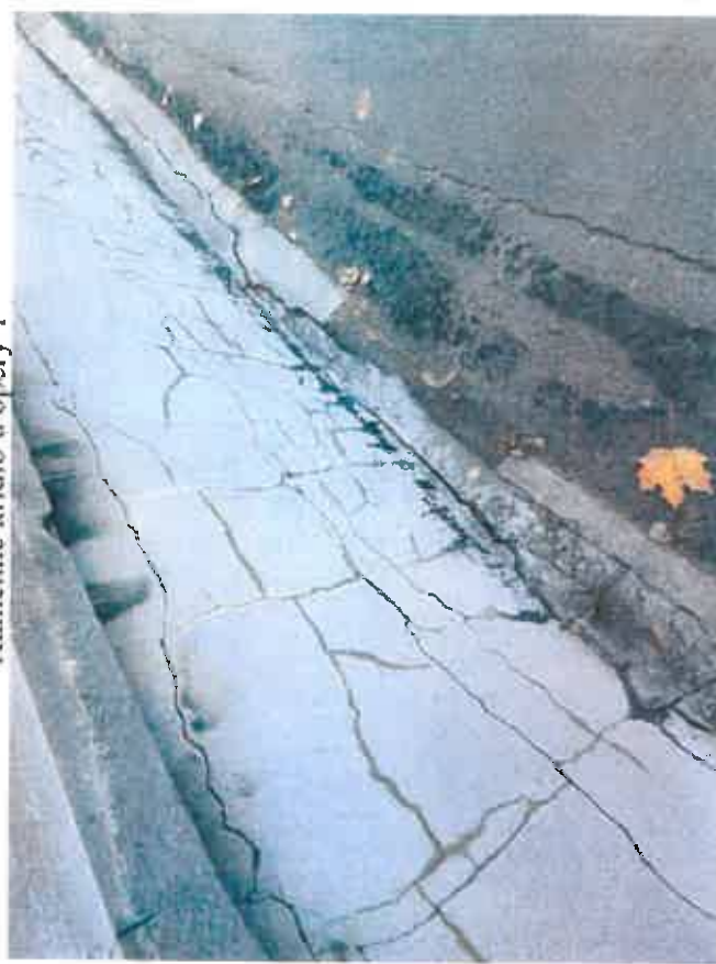
Sít' trhlin v parapetní zídce
