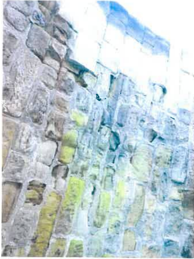
Zvětralé zdivo v otvoru 35
