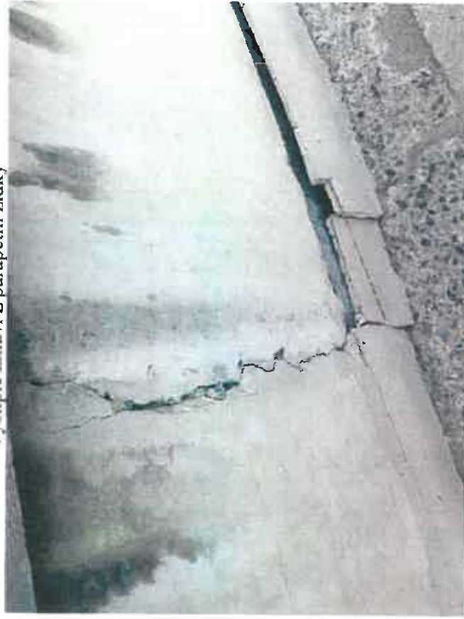
Zatékání a rozpad zidek
