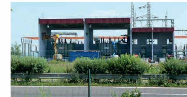
The transformer station - 110/22 kV / transformátorová stanice - 110/22 kV
