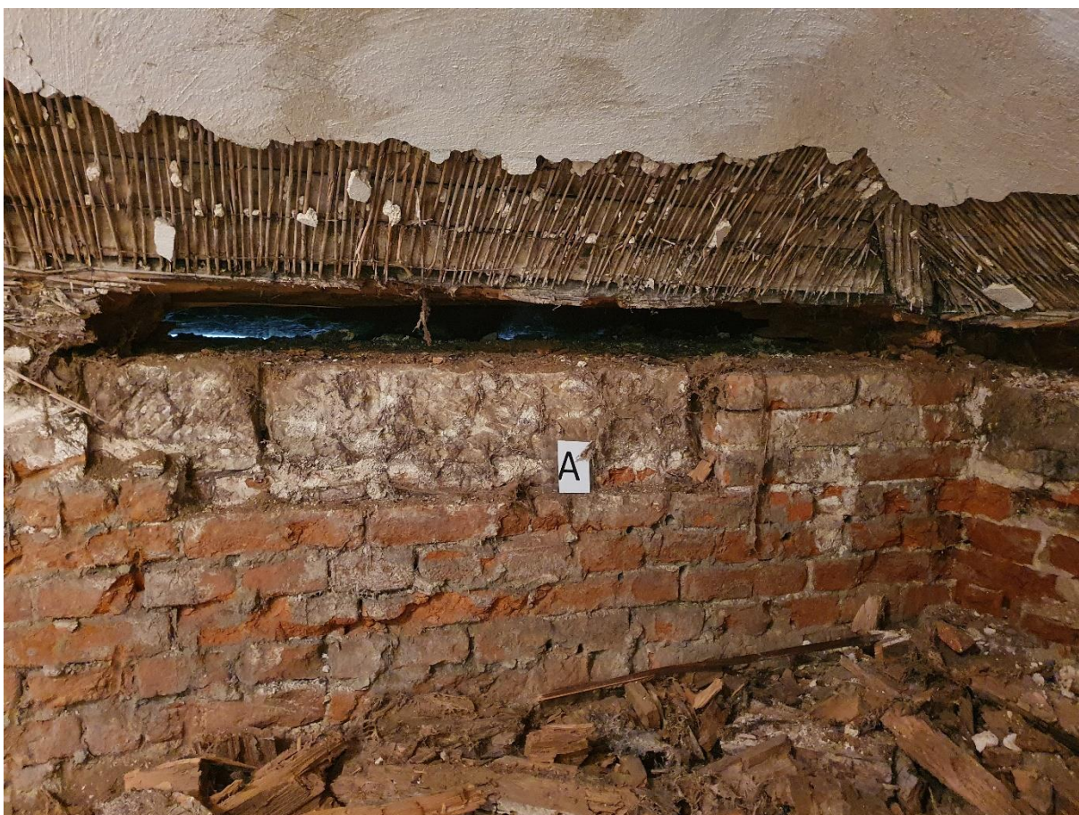
Východní stěna s viditelnou spárou mezi zdivem a krovem
