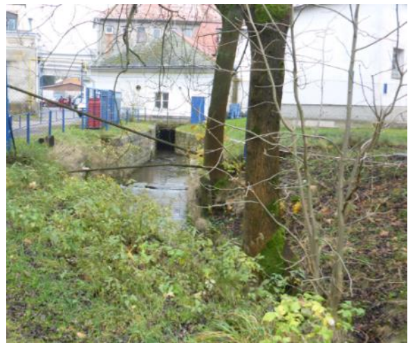
Obr. 87. Výtok ze zatrubnění z průmyslového areálu (-734476, -945161)
