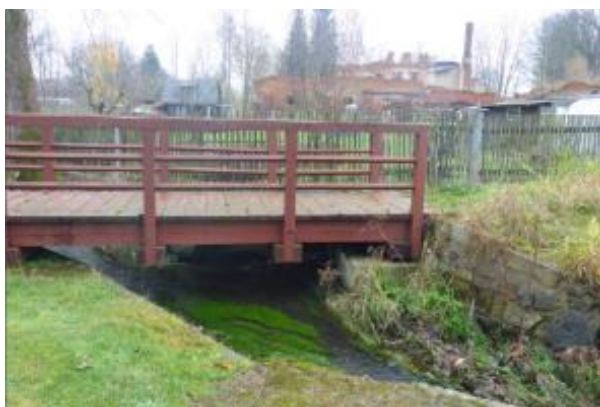
Obr. 131. Nevhodně umístěná lávka částečně v toku (-732869, -940447)
