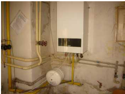
plynový kotel ÚT
