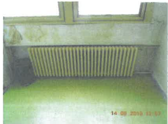
zatékání kolem oken
