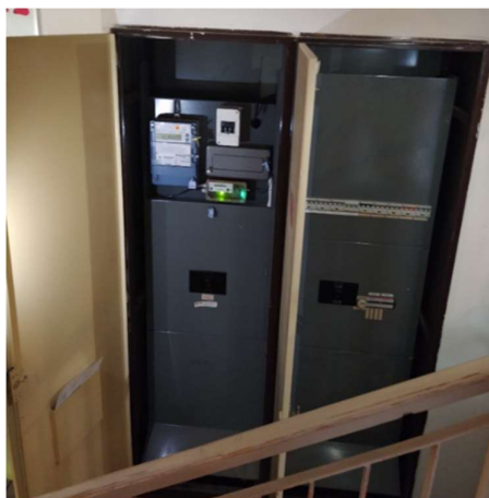
Obrázek 24: Stávající hlavní rozvaděč DSP Chotěšov
