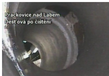
Kaverna nad potrubím
