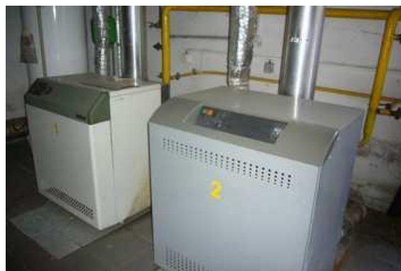
kotelna v admin. budově
