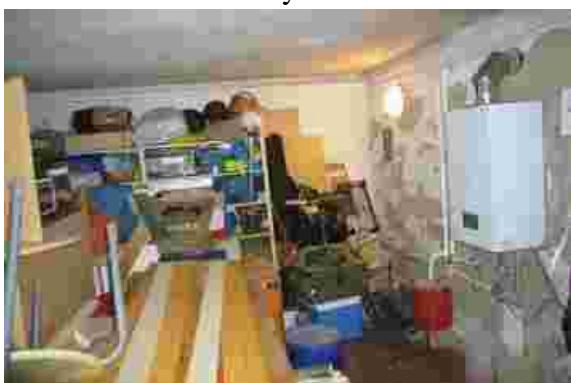
sklep s plyn. kotlem
