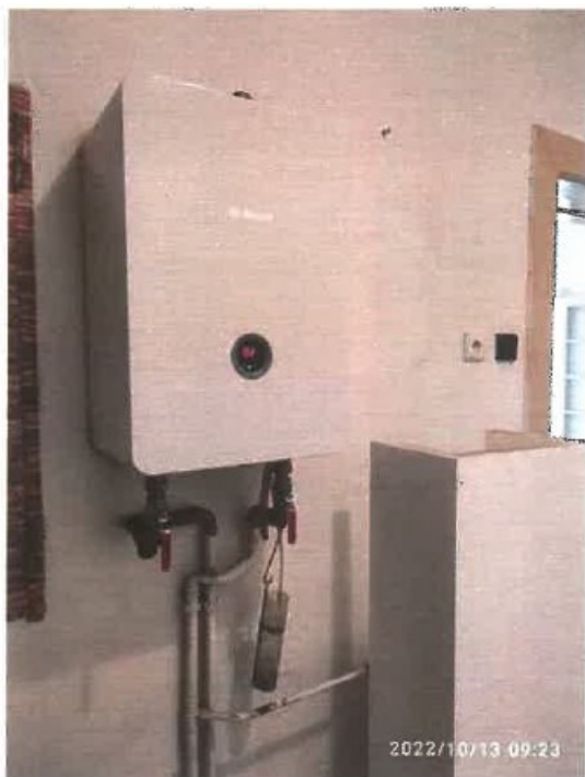
kotel na EI v 1.NP
