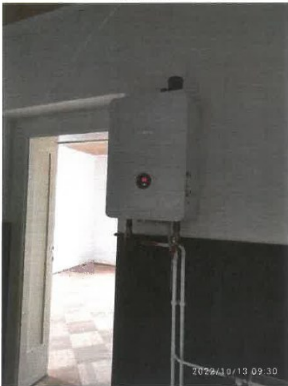
kotel na EI ve 2.NP
